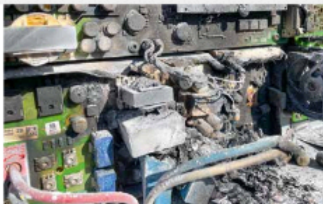
Ein Wespennest führt zu einem Kurzschluss in einem Wechselrichter.
