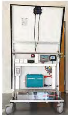
Links: Auch ein schöner Rücken ... Von unten nach oben: Batterie, Wechselrichter, Sicherungselemente, Steckdosen, Laderegler und Display
