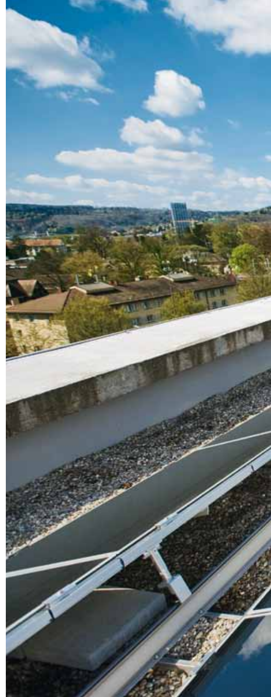
Die Photovoltaikanlage auf dem Dach der Kantonsschule Rychenberg profitiert von der Überbrückungsfinanzierung durch Stadtwerk Winterthur.
